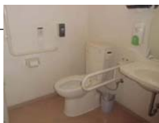
車いす用トイレ
